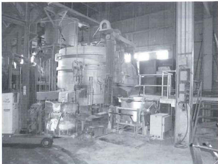
1.5ト集中溶解炉の横に設置された失敗なく搾れる灰搾り装置
